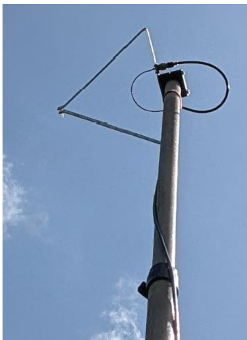
Fot. 4.3.3. Antena zamontowana na maszcie
